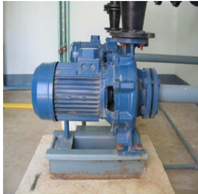
(2) โรงสูบน้ำดิบ
